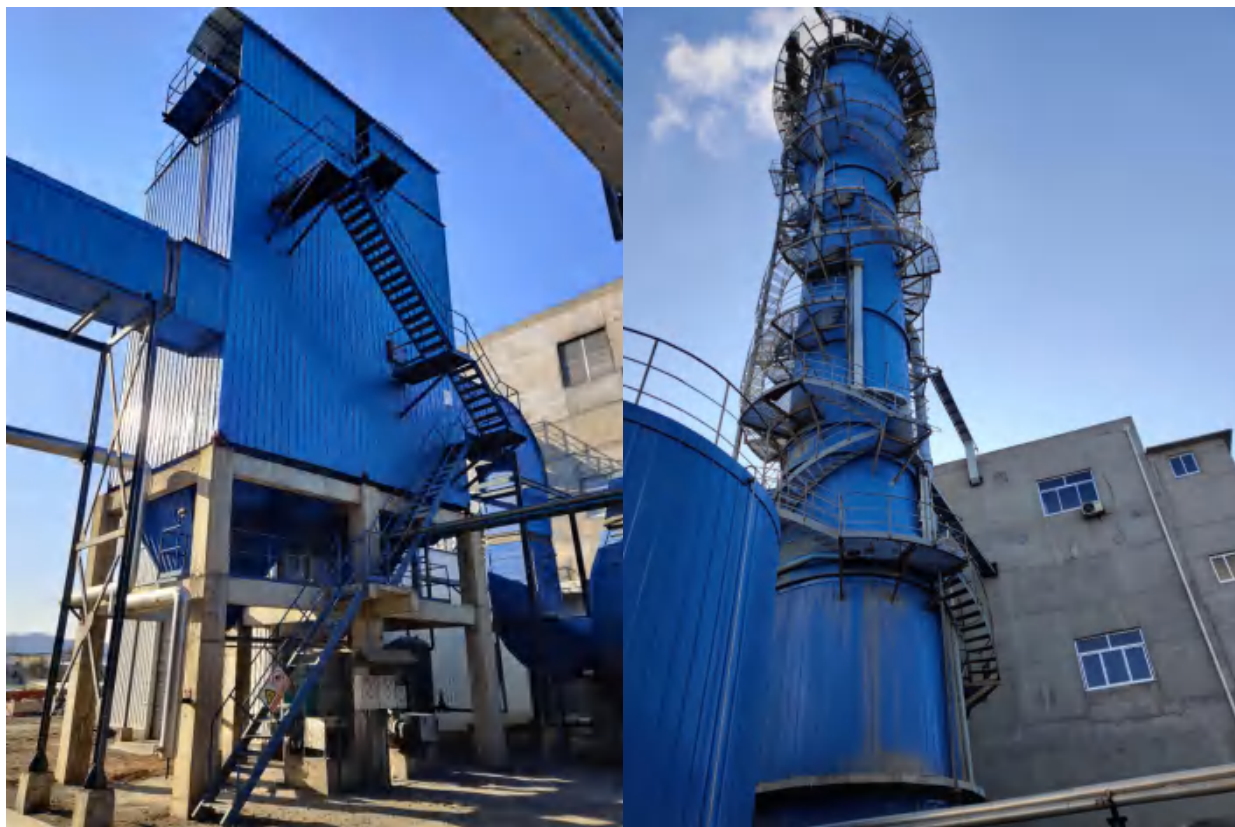
锅炉废气处理设施
